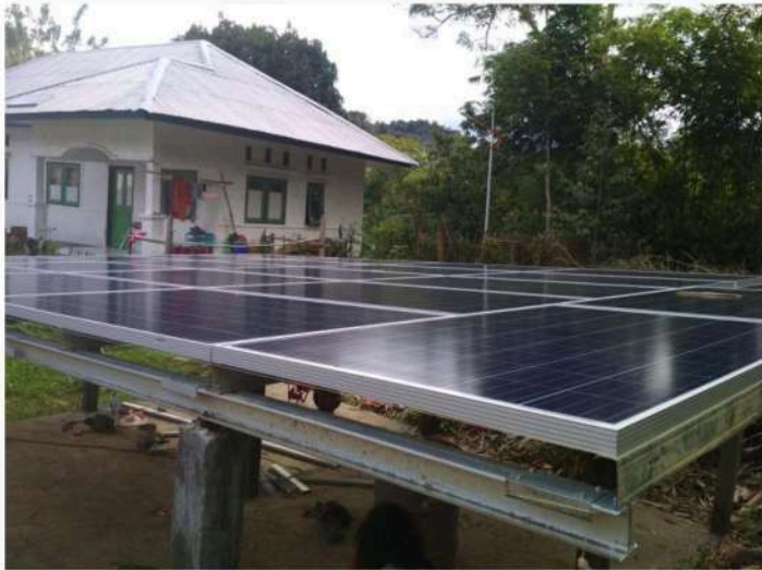
Solar Off-Grid System-Longnawang (Kaltara)
